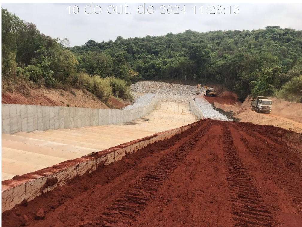
Figura 8.39 – Execução do aterro adjacente às paredes do canal rápido com material argiloso, após o módulo 12, com vista para jusante (10/10/2024).
