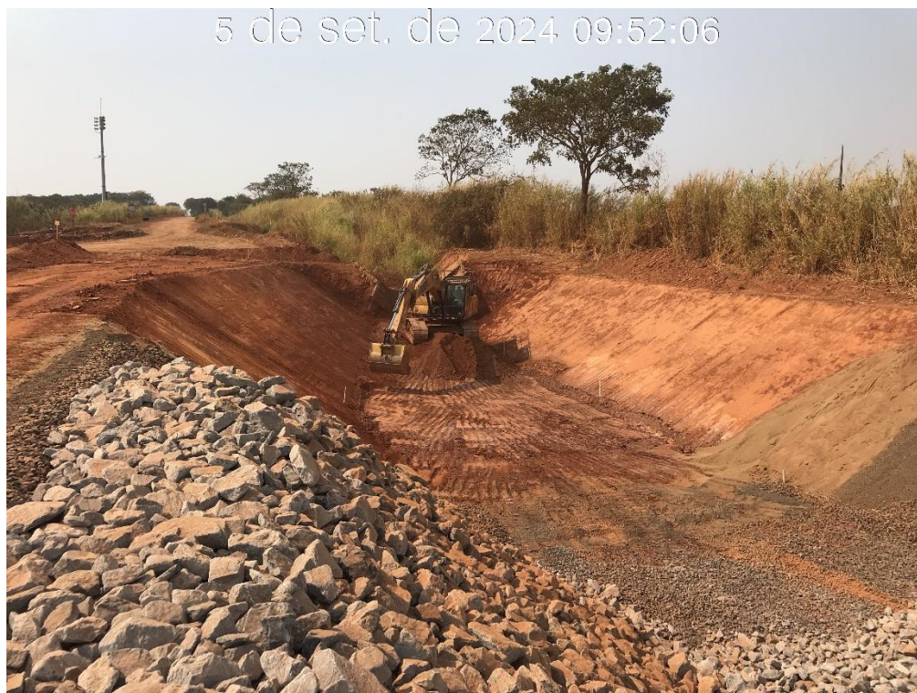
Figura 8.3 – Escavação entre as estacas 22 e 23, na região de transição com o canal existente, com vista para montante (05/09/2024).
