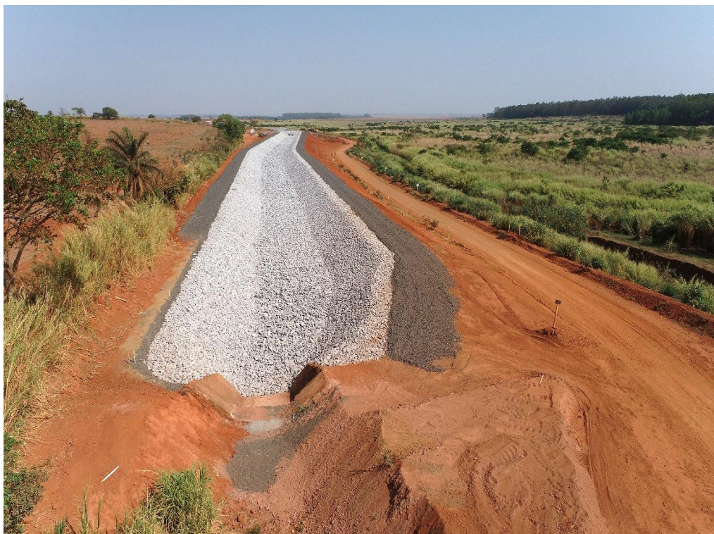
Figura 8.23 – Detalhe da região de transição entre o canal existente e o canal periférico, com vista para jusante (25/10/2024).
