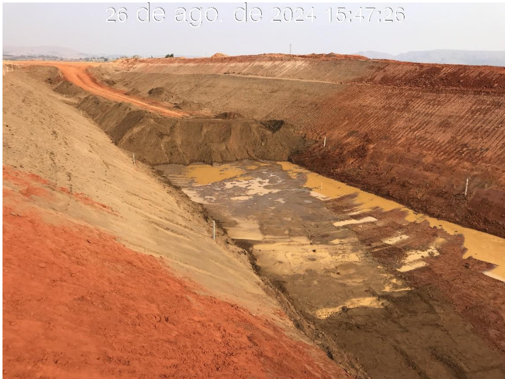
Figura 8.27 – Presença de água devido a elevação do N.A. do reservatório, com vista para montante (26/08/2024).
