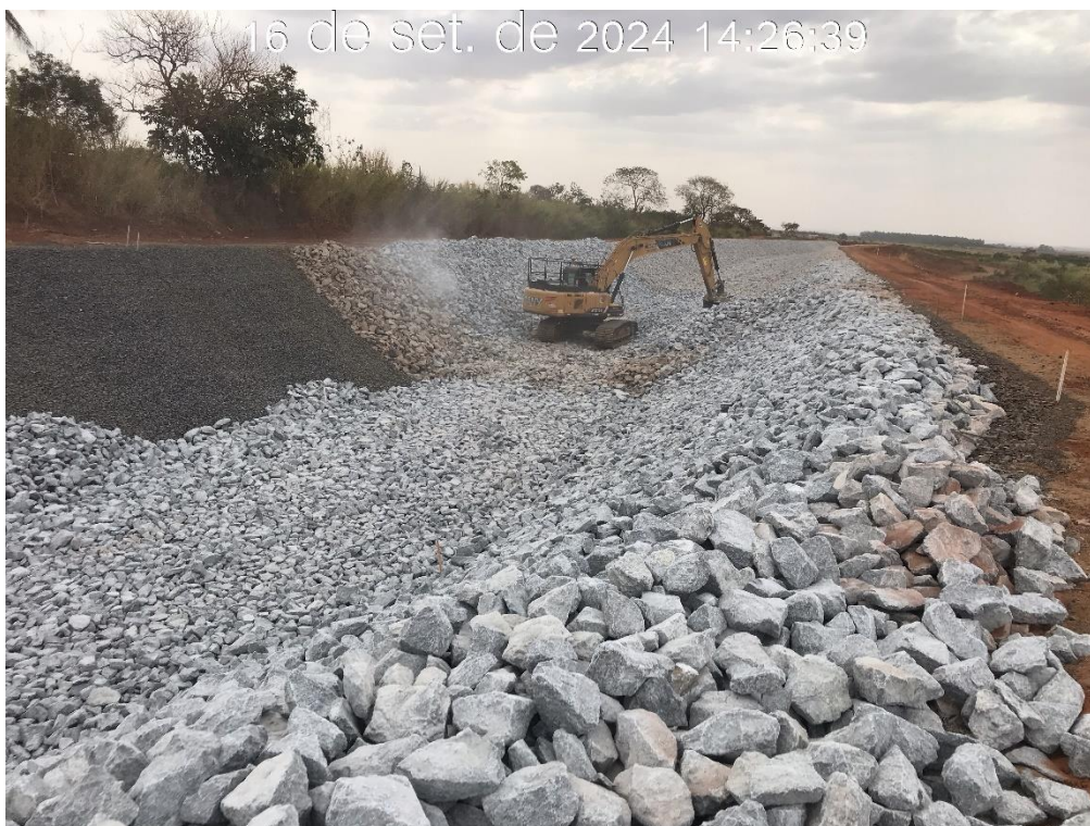
Figura 8.8 – Aplicação da camada de proteção (enrocamento), entre as estacas 22 e 23 do canal periférico, com vista para jusante (16/09/2024).
