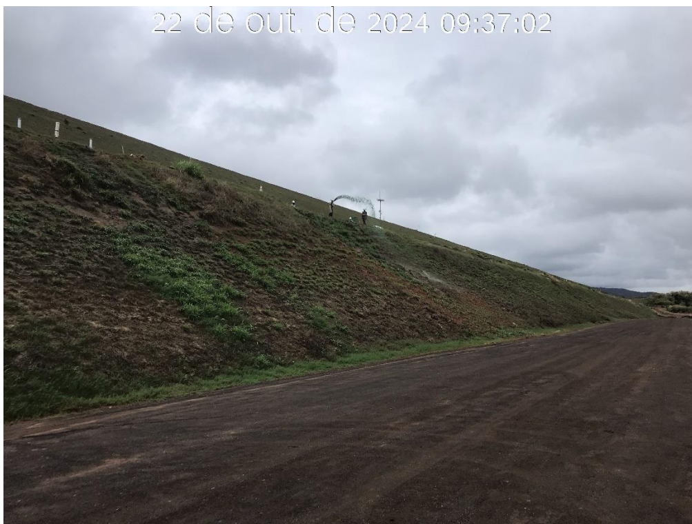
Figura 8.46 – Execução do plantio de grama por hidrossemeadura, entre as elevações 930,00 m e 940,00 m (22/10/2024).
