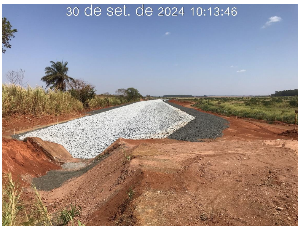
Figura 8.15 – Vista para jusante do canal periférico, com detalhe da região de transição com o canal existente (30/09/2024).
