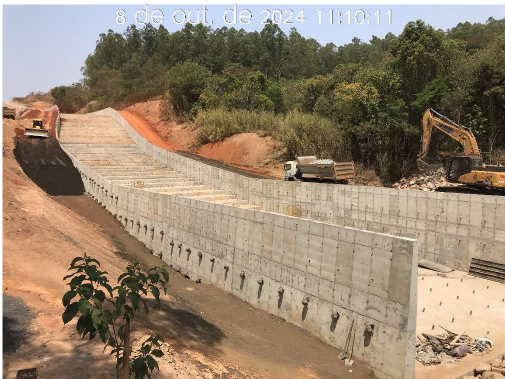
Figura 8.37 – Execução do aterro adjacente às paredes do canal rápido em magnetita, entre os módulos 07 e 12, com vista para montante (08/10/2024).
