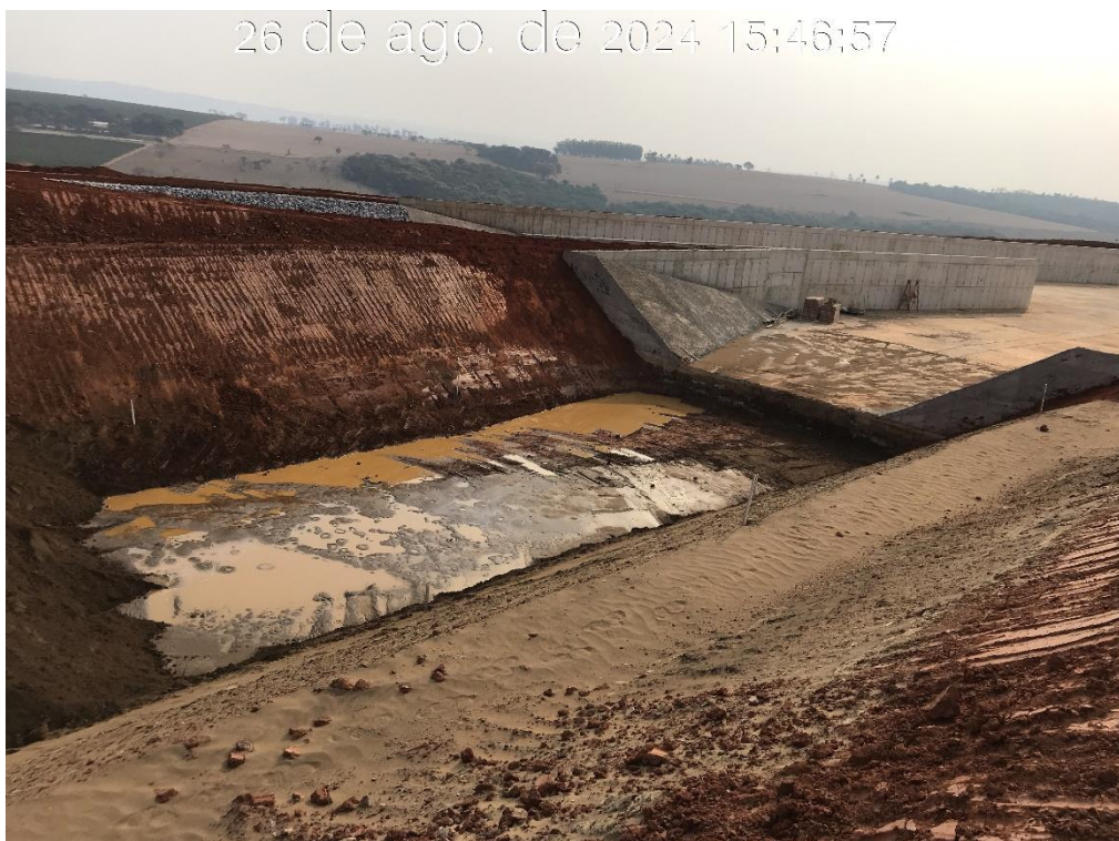
Figura 8.28 – Presença de água devido a elevação do N.A. do reservatório, com vista para jusante (26/08/2024).
