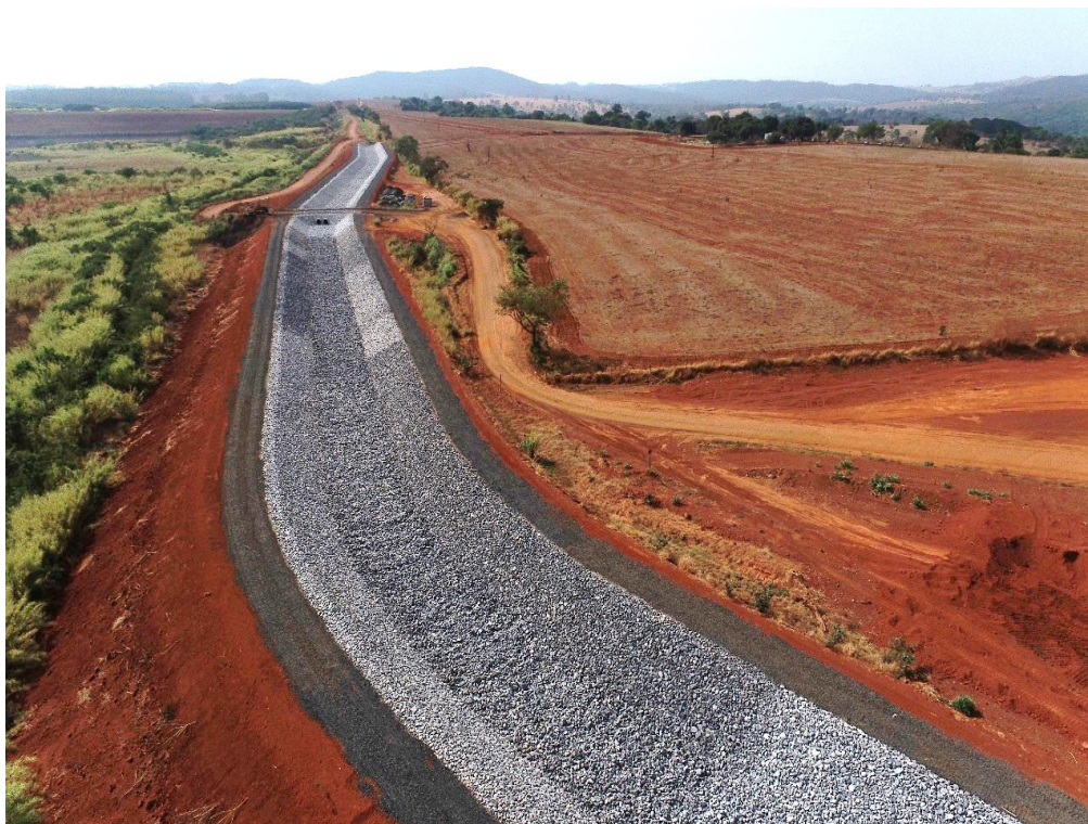
Figura 8.24 – Vista panorâmica para montante do canal periférico, na região da estaca 60, com vista para montante (25/10/2024).
