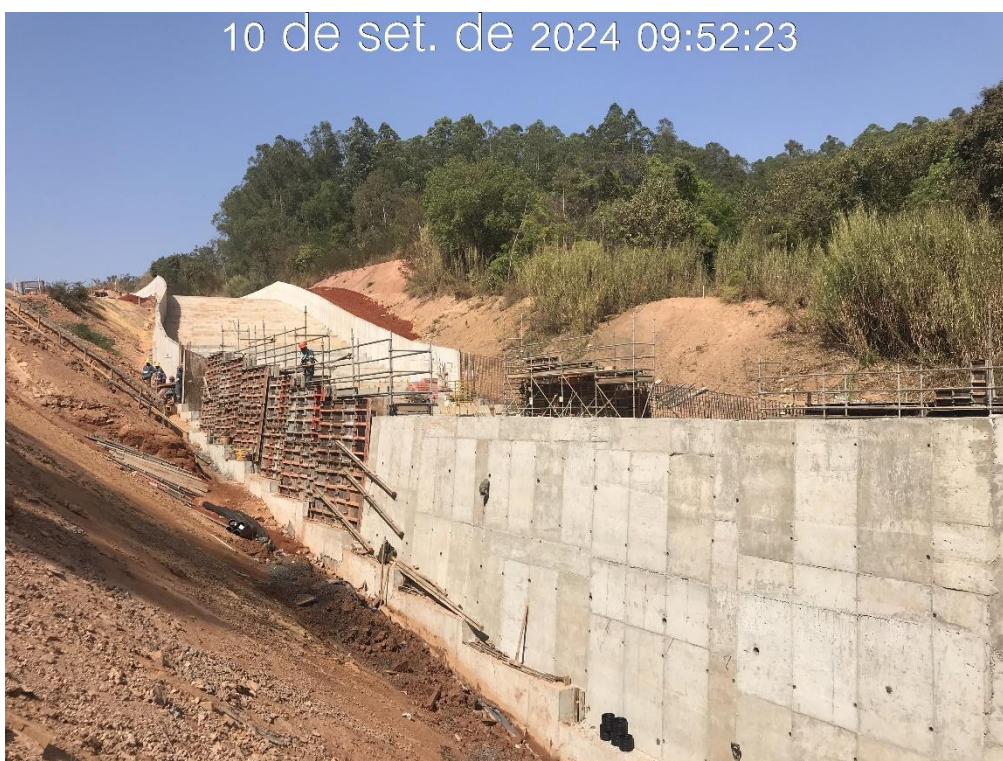
Figura 8.35 – Vista para montante do canal rápido, com detalhe da montagem das formas nos módulos 09 e 10 (10/09/2024).
