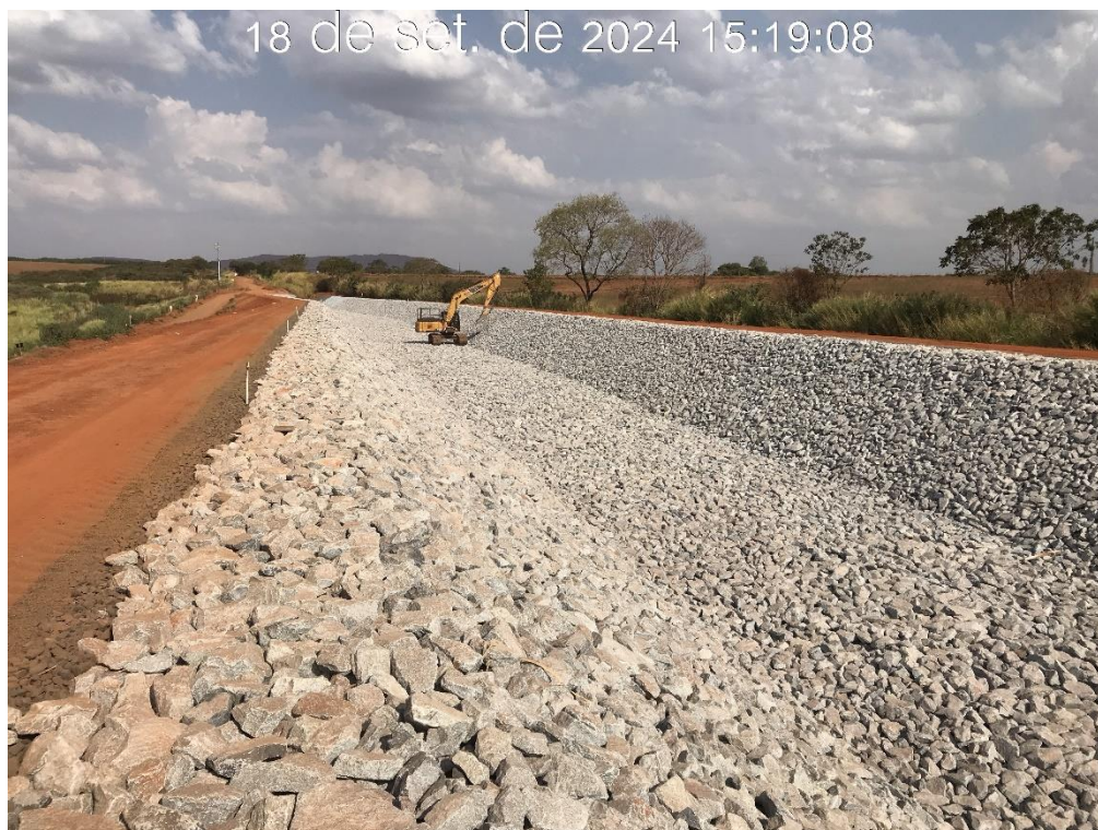
Figura 8.10 – Regularização da camada de proteção (enrocamento), entre as estacas 22 e 44, com vista para montante (18/09/2024).
