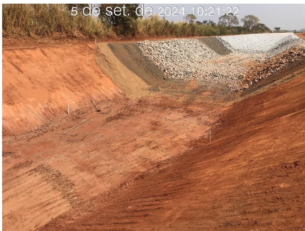
Figura 8.4 – Escavação entre as estacas 22 e 23, na região de transição com o canal existente, com vista para jusante (05/09/2024).
