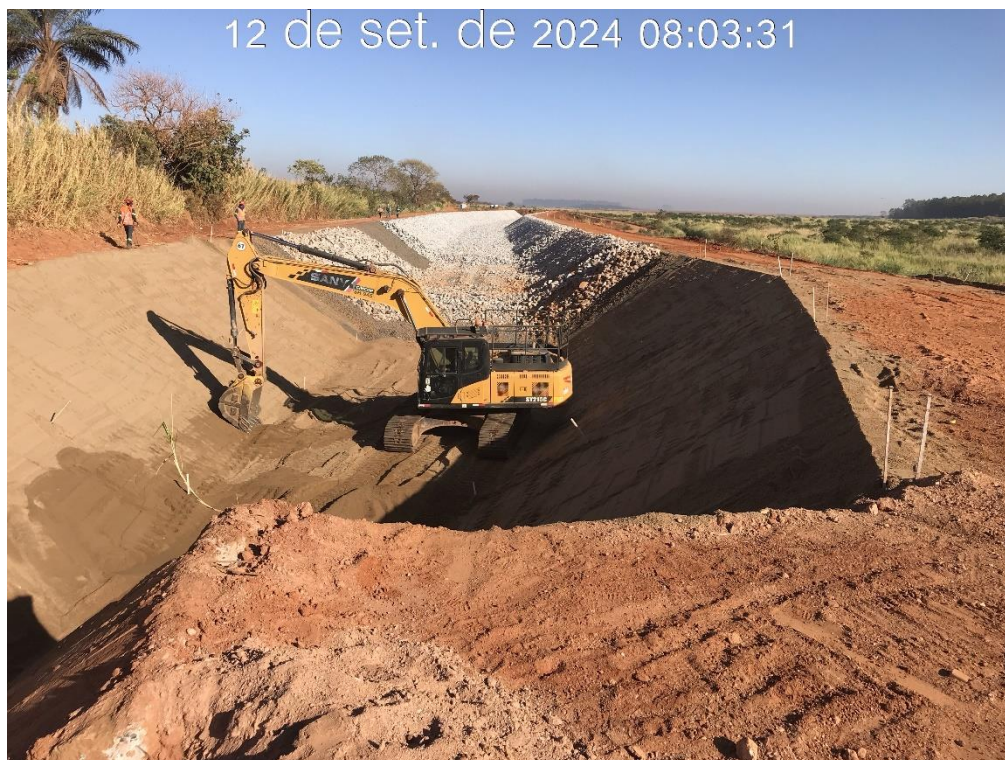
Figura 8.5 – Aplicação da transição 1 (areia), entre as estacas 22 e 23 do canal periférico, com vista para jusante (12/09/2024).
