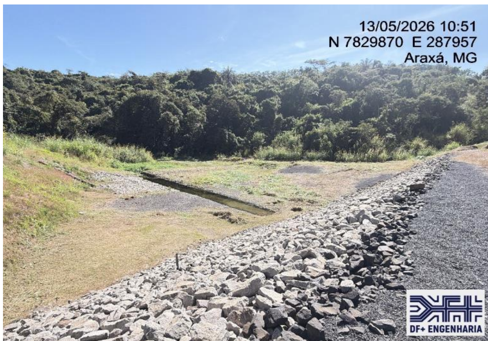
Figura 35 – Platô do medidor de vazão (13/05/2025).
