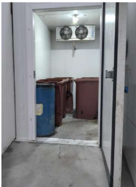
Figura 8 - Câmara fria de armazenamento de resíduos orgânicos
