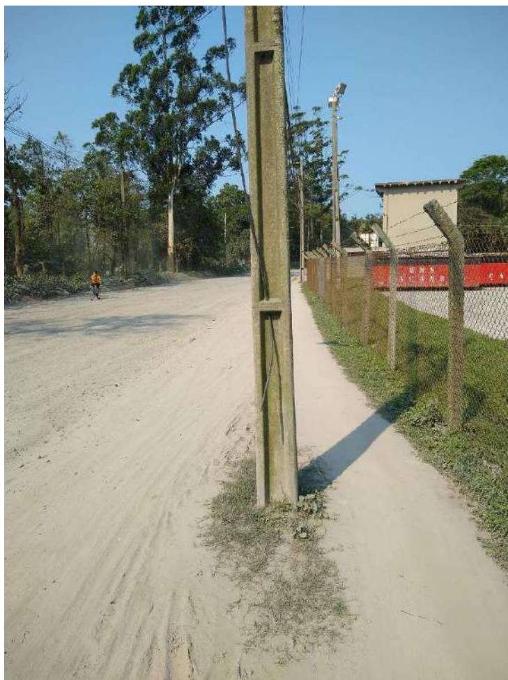
Figura 1 – Calçada com interferência do poste
