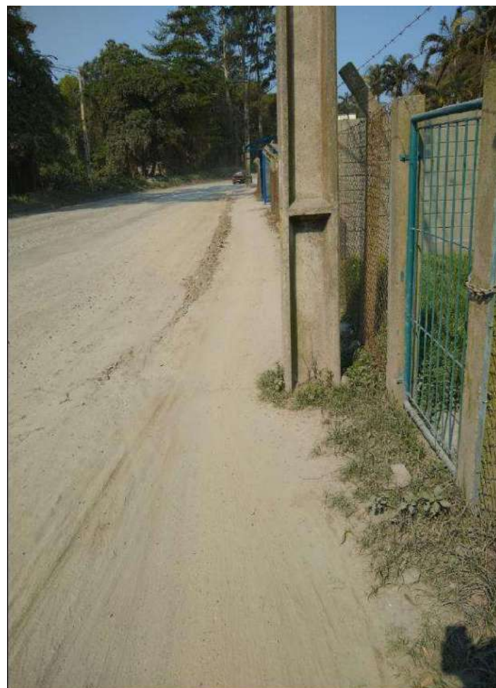
Figura 2 – Calçada com interferência do poste
