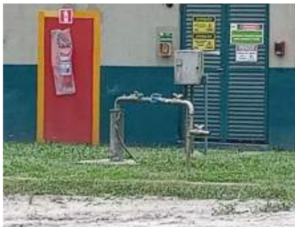
Poço de captação D Dez-2023)
