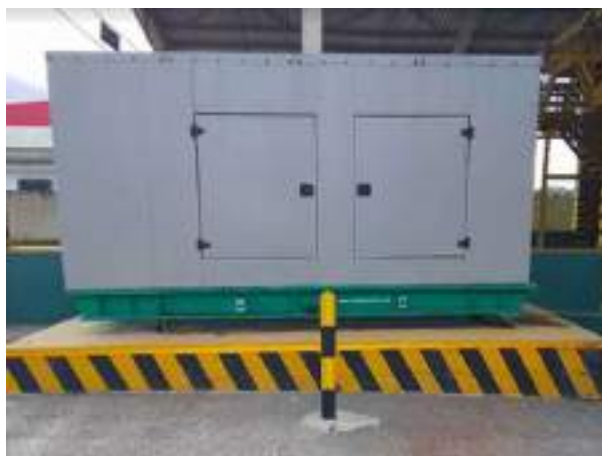
Vista geral do gerador de emergência (Dez-2023)
