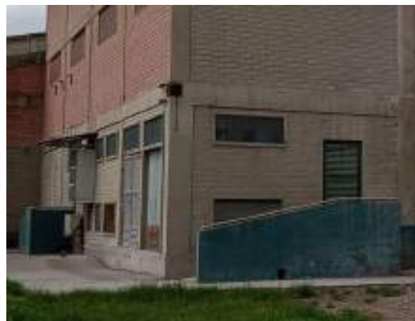
Área da Subestação 02 (Dez-2023)
