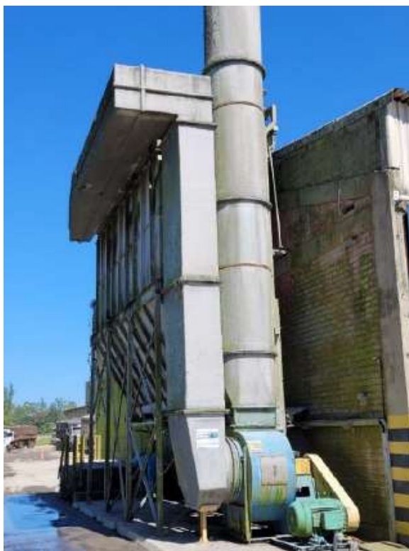
Filtro de mangas da descarga de matérias primas (Dez-2023)
