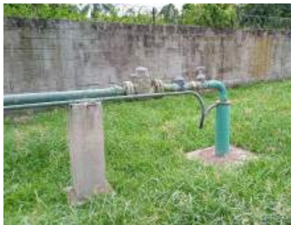
Poço de captação C (Dez-2023)
