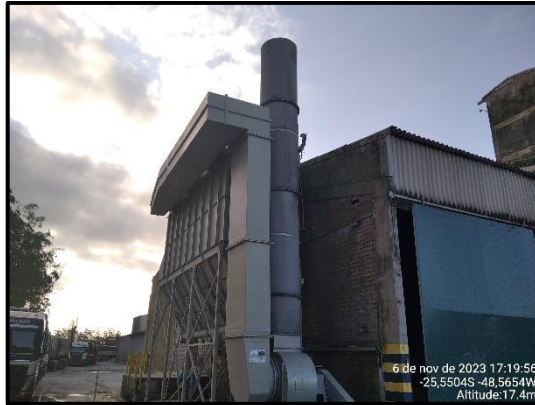
Figura 16 – Sistema de filtros para controle da qualidade do ar.
