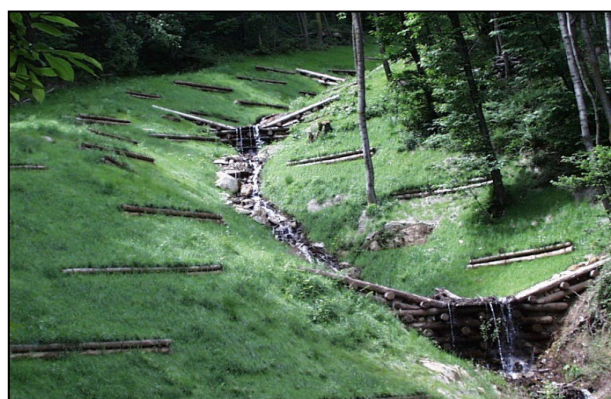
Figura 21-6 - Aplicação integrada de paliçadas ao projeto paisagístico de recomposição ambiental (VERTICAL GREEN, 2022)
